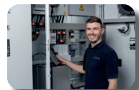
Schaltschrankbau und Elektroplanung
